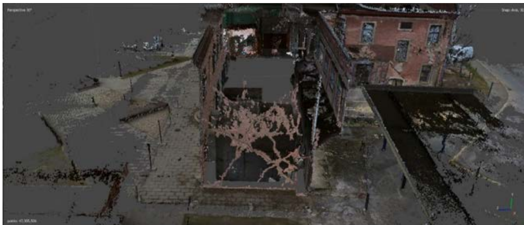
Slika 11 Loša kvaliteta istočnog pročelja
