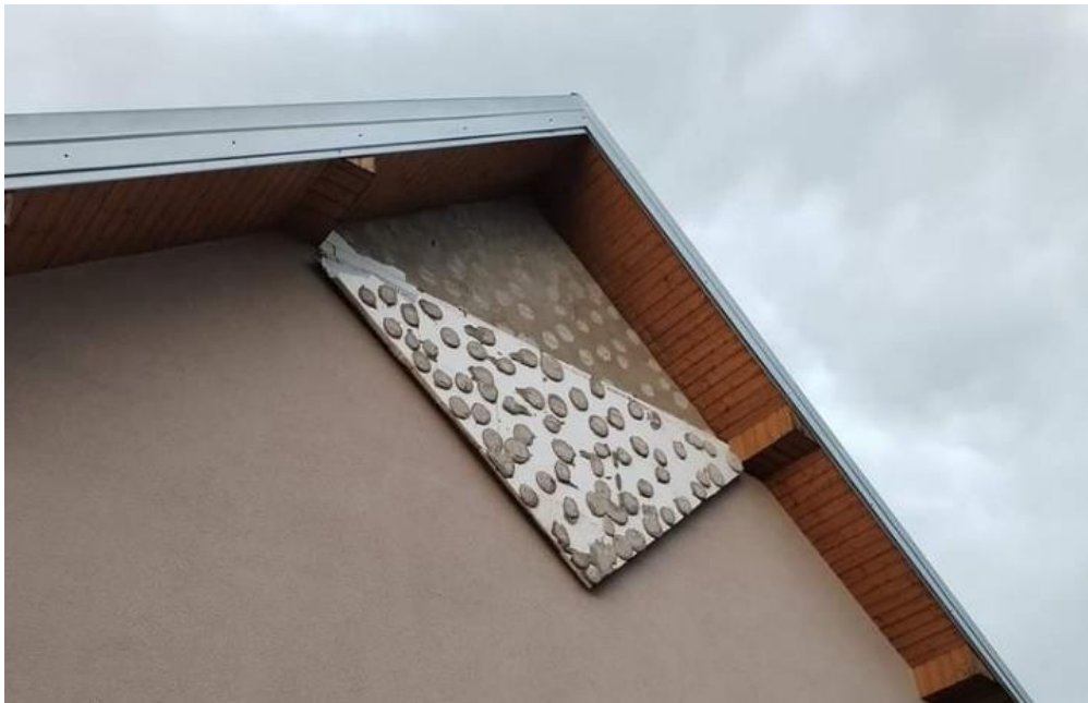
Slika 28. Nepravilno izvedena izolacija stiroporom
