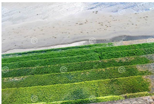
Slika 17 Alge na betonskim stepenicama
