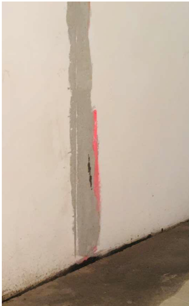
Slika 5. Prekid betoniranja - radni taktovi loše izvedeni
