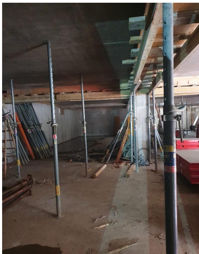
Slika 52. Skidanje stropne oplata na području podzemne garaže objekta - ostavljena oplata greda i podupirači
