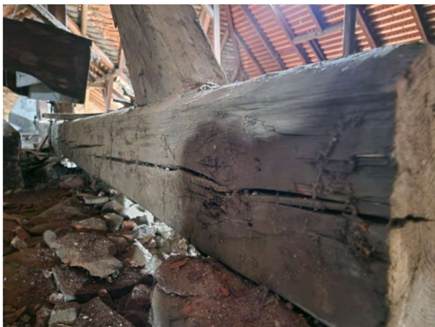
Slika 26. Uzdužno oštećenje na jednoj veznoj gredi
