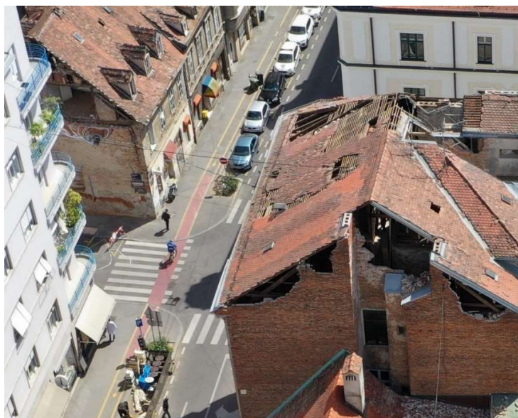
Slika 1. Prikaz oštećenja tipične donjogradske zgrade u Zagrebu
