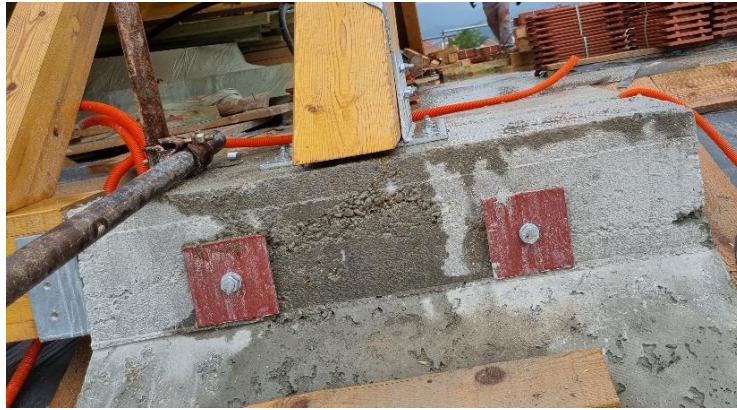
Slika 53. Sidrene pločice i vijci ugrađenih zatega (Foretić, 2021)
