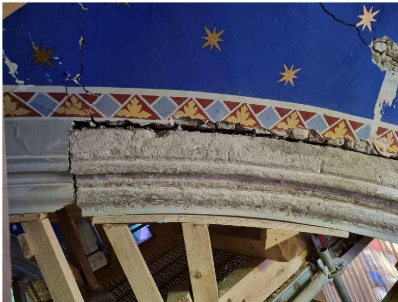
Slika 21. Detalj sloma rebara na svodu crkve (Foretić, 2021)
