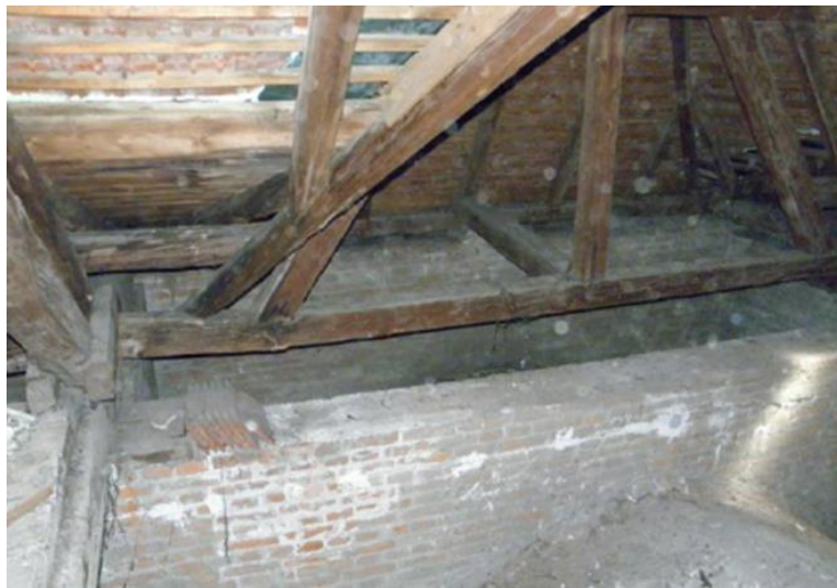
Slika 27. Oštećenje greda drvenog krovništva (Foretić i Trogrlić, 2021)
