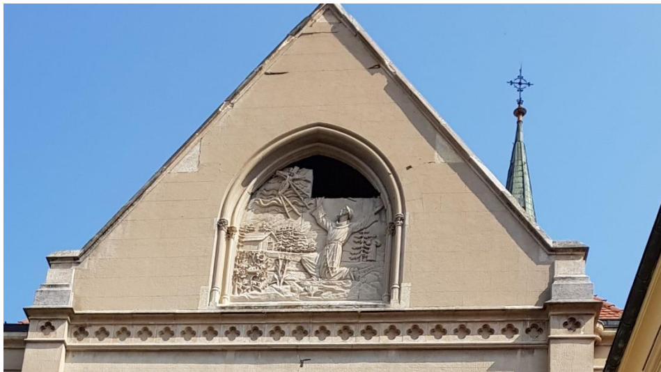
Slika 25. Oštećenja na zabatnom zidu i reljefu (Foretić, 2021)
