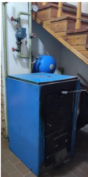
Slika 6.3. Kotao na drvenu sječku
