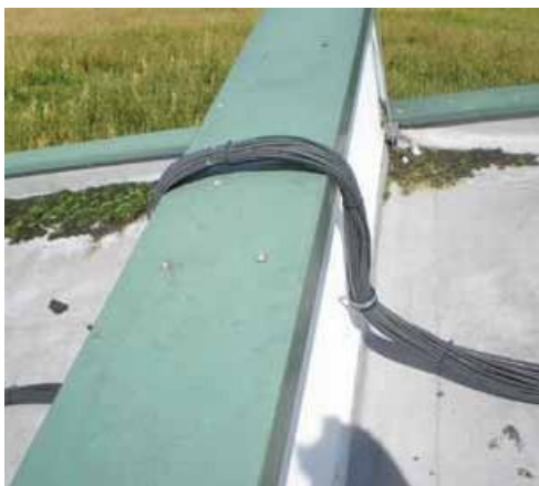
Slika 14 Nedozvoljeno postavljanje kablova preko požarnog zida (31)
