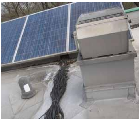
Slika 18 Nestručno postavljanje vodova (31)
