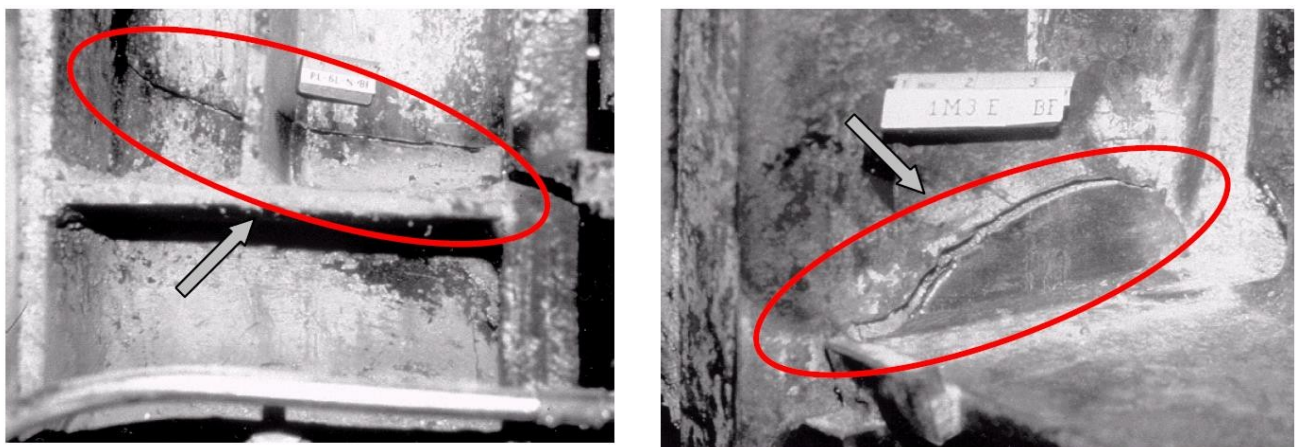
Slika 4 Krsti lom donjih pojasnica grede u zavarenoj MRF vezi tijekom potresa Northridge, California, 1994 : lom koji se širi kroz spoj stupa i pojasnicu (lijevo) i lom koji uzrokuje otkazivanje stupa [5]
