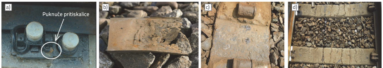
Slika 3. a) Primjer puknuća pritiskalice [10]; b) istrošenje podtračničkog podloška [20]; c) ležajnog mjesta na pragu [24]; d) puknuće betonskih pragova [23]
