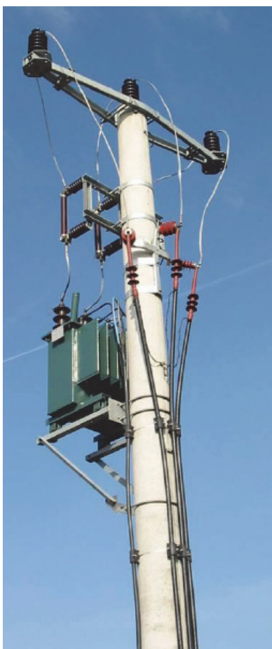
Slika 3. Konvencionalni stup u elektroprijenosnoj mreži
