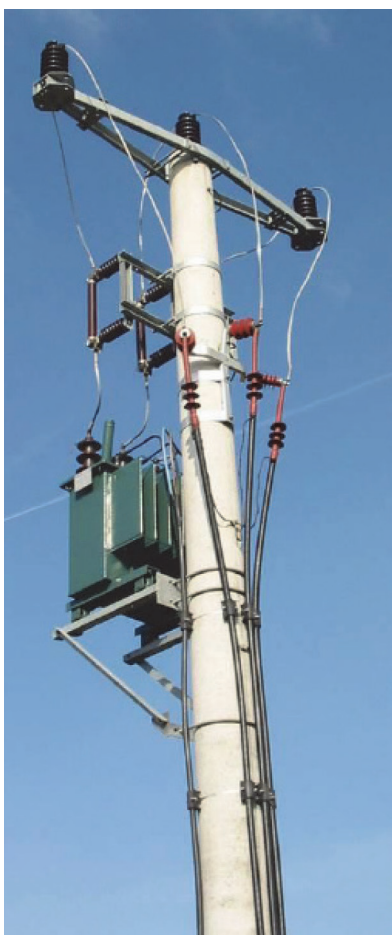
Slika 3. Konvencionalni stup u elektroprijenosnoj mreži
