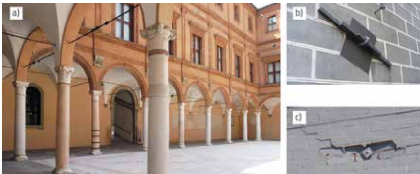
Slika 9. Čelične zatege: a) Primjer starih i nedavno ugrađenih zatega (iznad starih); b) Detalj sidrenja zatega; c) Tipični način otkazivanja
