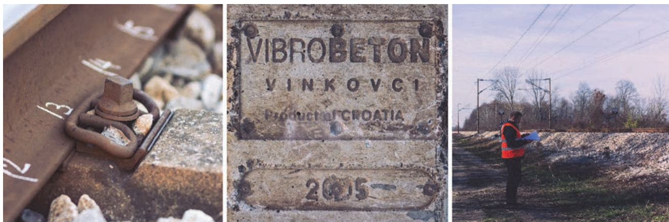
Slika 9. Pričvršćenje tračnice elastičnom pritiskalicom SKL-8 (lijevo), armiranobetonski pragovi na ispitnoj dionici (sredina) i prikaz zastorne prizme od drobljenca (desno)
