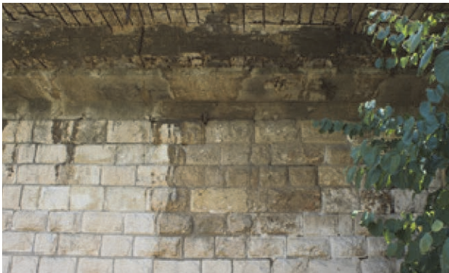
Slika 4. Izbočenje i promjena boje čeonog zida
