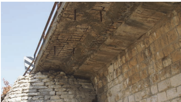
Slika 5. Loše stanje konzola mosta
