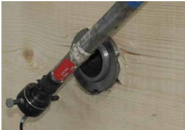
Slika 9. Deformacija srednjeg priključka druge rešetke
