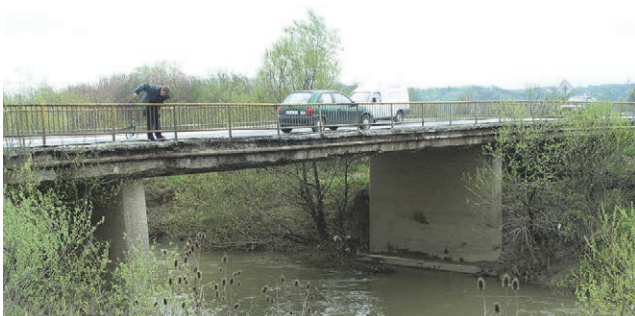
Slika 1. Most pod upravom Hrvatskih cesta prije sanacije 2012. godine – karakteristična oštećenja vijenca i rasponskog sklopa
