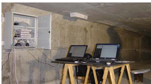
Slika 3. Monitoring centar (mjerna stanica)
