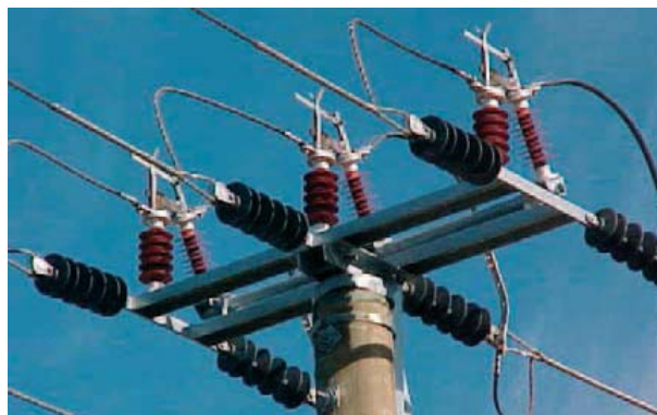
Slika 10. Kompozitni potporni izolatori ugrađeni na rastavljaču
