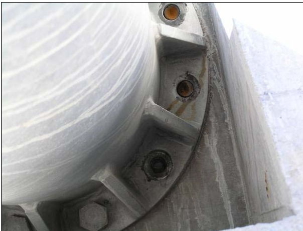
Slika 10. Popucani visokovrijedni vijci na spoju zaštitne cijevi na pilon
