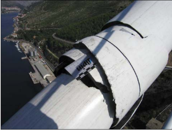
Slika 9. Oštećenje zaštitne cijevi
