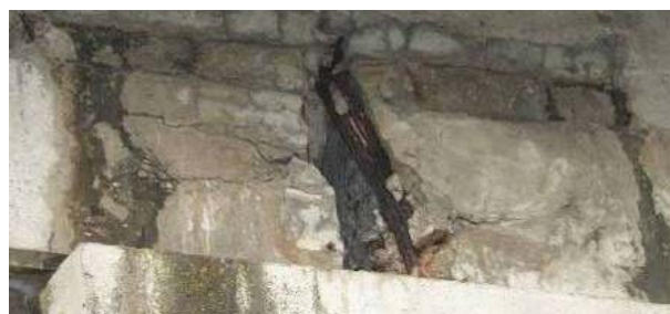
Slika 15. Neuredna izvedba zaštite kotvi natega za poprečno prednapinjanje nadvožnjaka tipa DK
