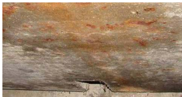
Slika 14. Oštećenja donje plohe nosača zbog prodora vode uz oslonce nadvožnjaka tipa DK
