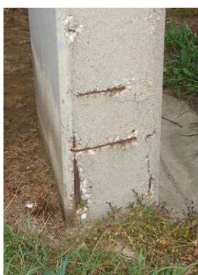
Slika 25. Odlamanje zaštitnog sloja na stupcima nadvožnjaka tipa DK
