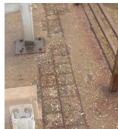
Slika 33. Otkrivena armatura hodnika
