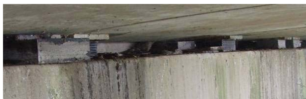
Slika 34. Oštećeni, izmaknuti i ekscentrično opterećeni elastomerni ležajevi
