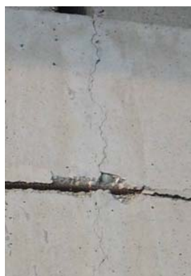
Slika 26. Karakteristična vertikalna pukotina na naglavnoj gredi nadvožnjaka tipa DK
