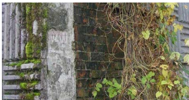
Slika 20. Karakteristično oštećenje upornjaka nadvožnjaka tipa SO
