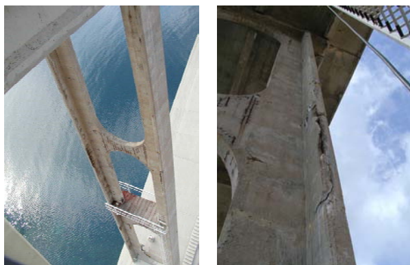
Slika 4. Oštećenja na stupu S21
