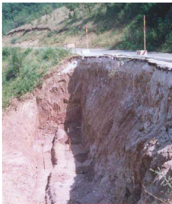
Slika 4. Karakterističan odron uz prometnicu u fazi sanacije
