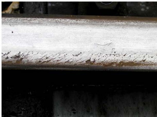
Slika 1. Oštećenja na voznoj površini tračnice
