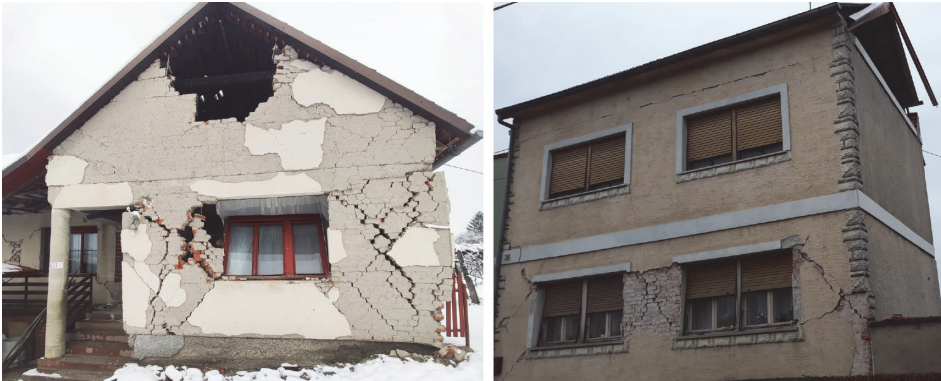
Slika 1. Zidane građevine oštećene u potresu
