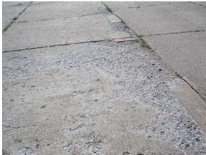
Slika 15. Ljuštenje (veliko oštećenje) [15]
