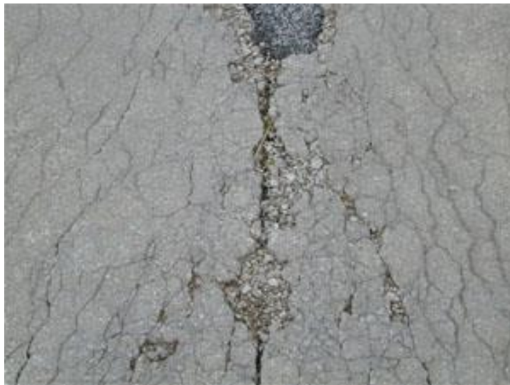
Slika 11. „D” pukotina (veliko oštećenje) [15]
