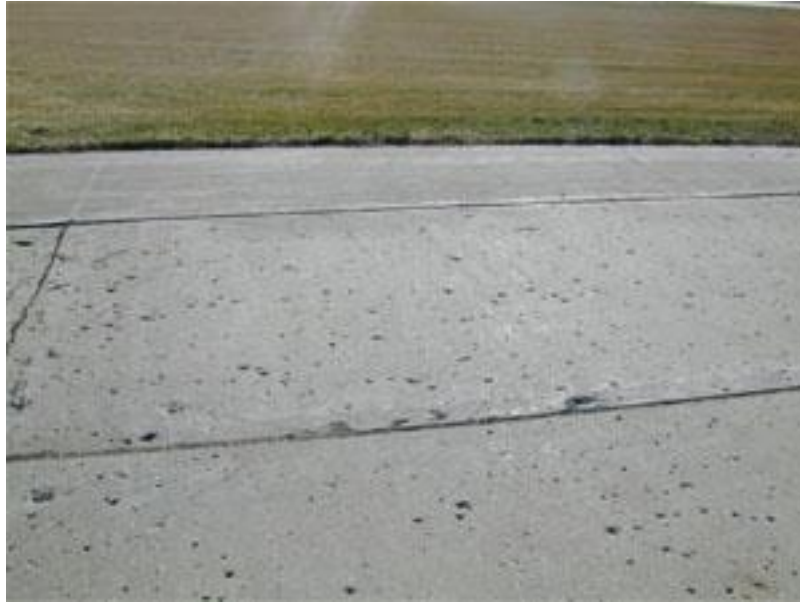
Slika 14. Odvajanje zrna agregata [15]
