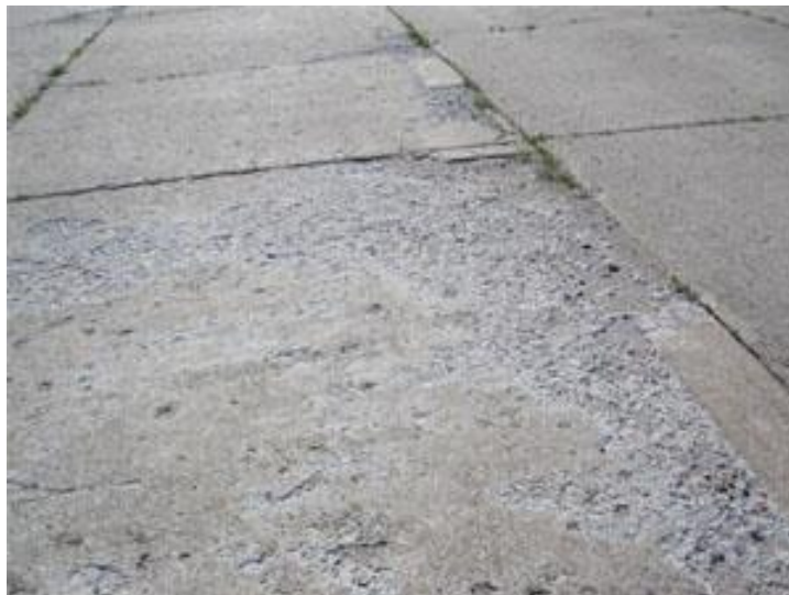
Slika 15. Ljuštenje (veliko oštećenje) [15]
