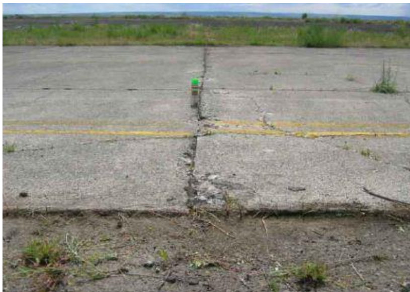
Slika 8. Denivelacija ploča (malo oštećenje) [15]
