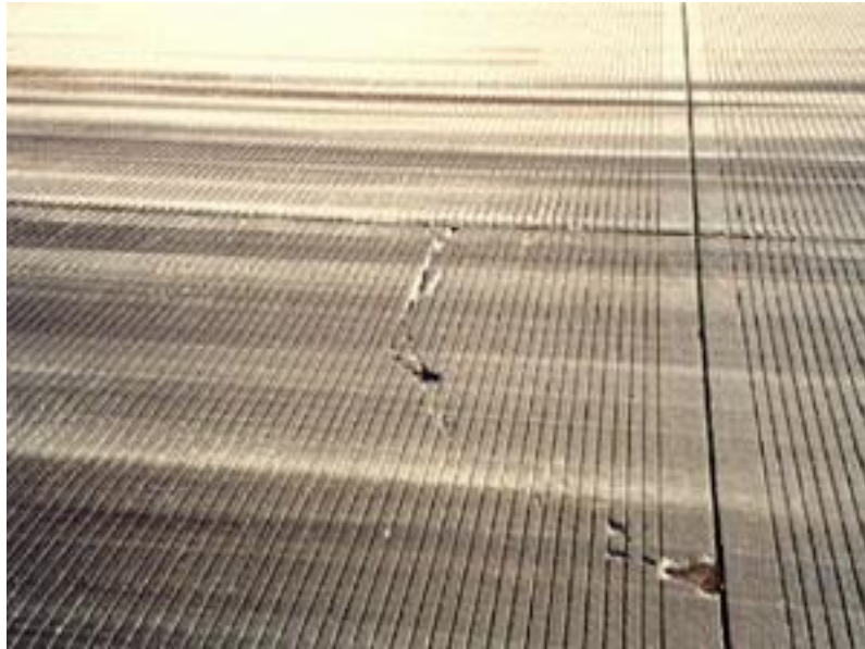
Slika 9. Kutna pukotina (srednje oštećenje) [15]
