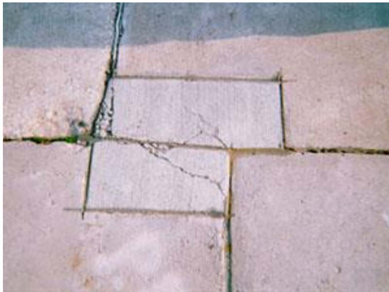
Slika 13. Zakrpa (srednje oštećenje) [14]
