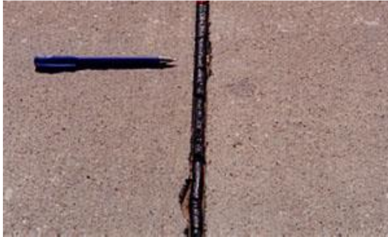
Slika 12. Oštećenje ispune razdjelnica (srednje oštećenje) [15]
