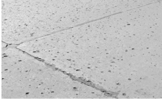
Slika 8. Ispadanje zrna agregata na površini betonskog kolnika [9]
