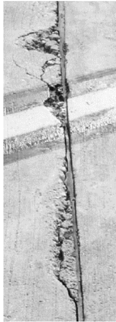
Slika 13. Pukotina duž spoja [9]
