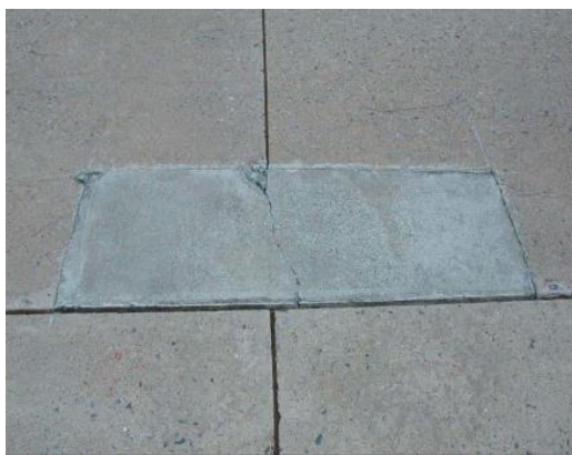
Slika 6. Mala zakrpa srednjeg stupnja oštećenja [8]
