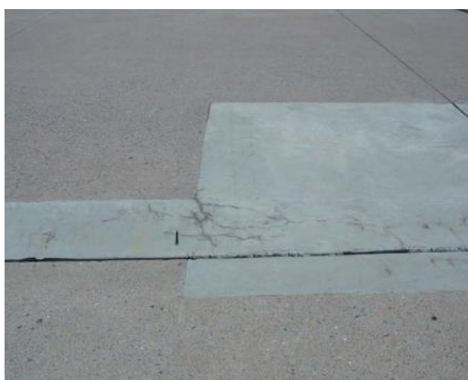
Slika 7. Velika zakrpa srednjeg stupnja oštećenja [8]
