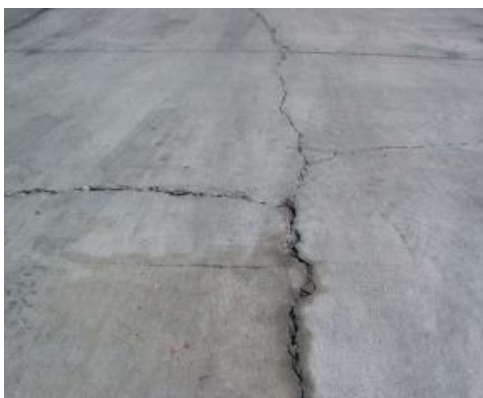
Slika 11. Visoki stupanj oštećenja tipa lom ploče [8]
