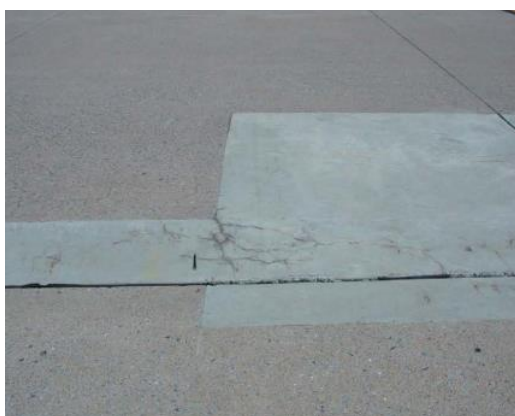
Slika 7. Velika zakrpa srednjeg stupnja oštećenja [8]
