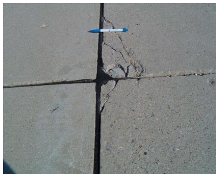
Slika 14. Visoki stupanj oštećenja odlamanja betona kuta ploče[8]
