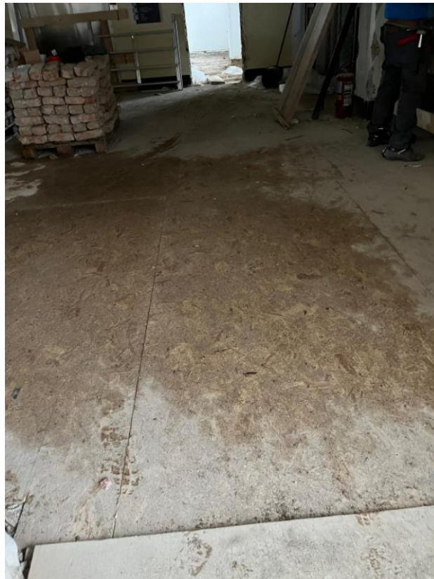
Slika 8.: Zaštićena podna obloga
