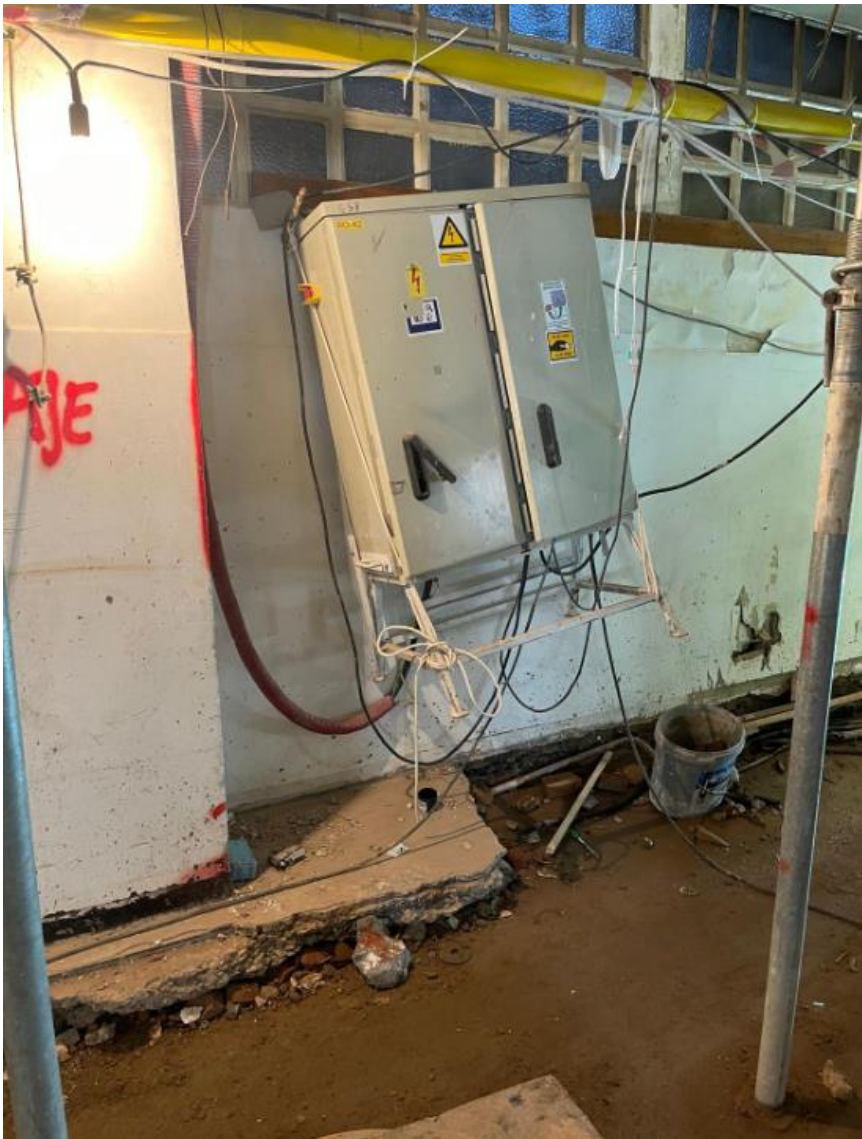
Slika 45.: Nepravilno postavljen ormarić za struju
