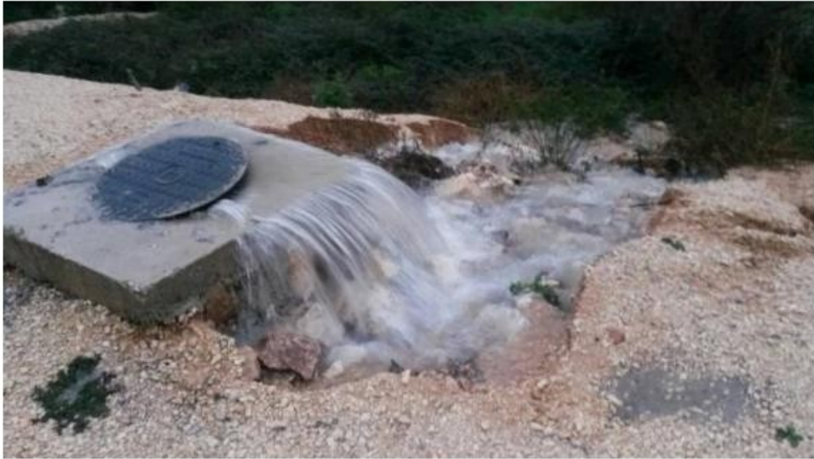
Slika 10. Nekontrolirano ispuštanje pri pojavi oborine PP 5 g. [9]
