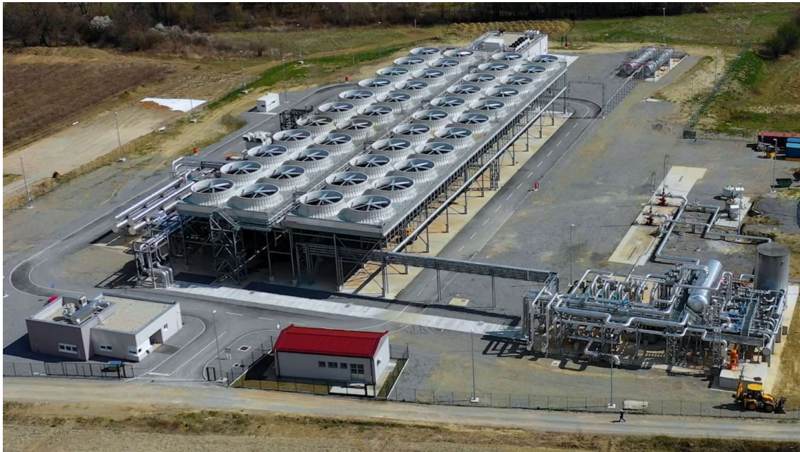
Slika 15.: Geotermalna elektrana „Velika 1“ (OIE Hrvatska, 2019)
