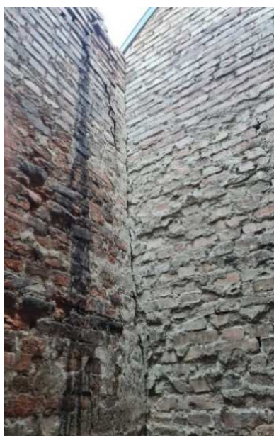
Slika 27: Sjeverni svjetlarnik sa vidjivim pukotinama nakon potresa 2020.
