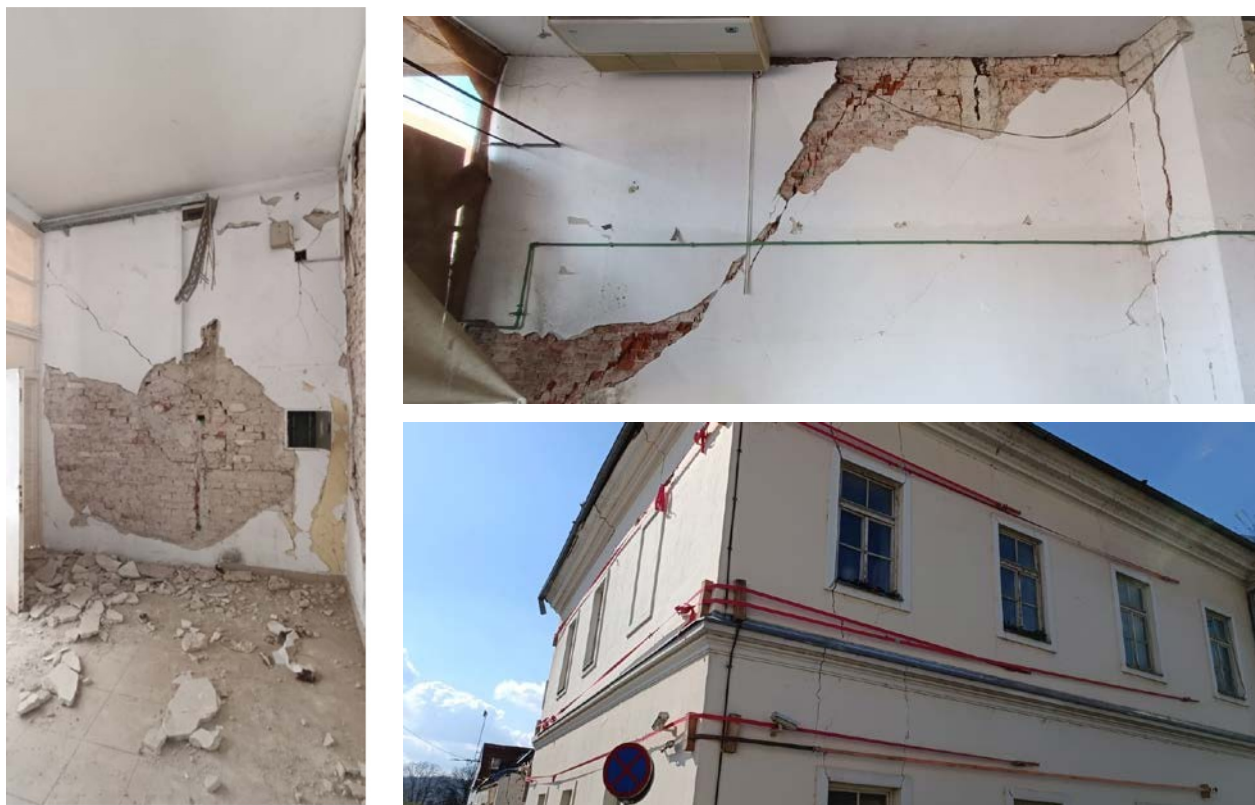
Slika 10: Primjer vanjskih i unutarnjih oštećenja u Petrinji (izvor: autor)
