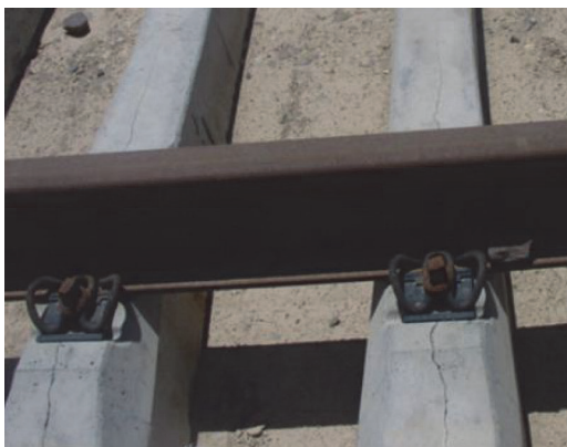
Slika 7. Uzdužna pukotina na betonskome pragu
