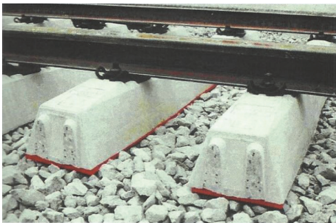
Slika 6. Elastični podložak ispod betonskoga praga [1]
