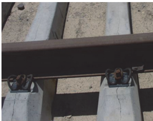
Slika 7. Uzdužna pukotina na betonskome pragu
