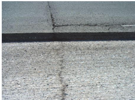
Slika 3. Poprečna i uzdužna pukotina [4]
