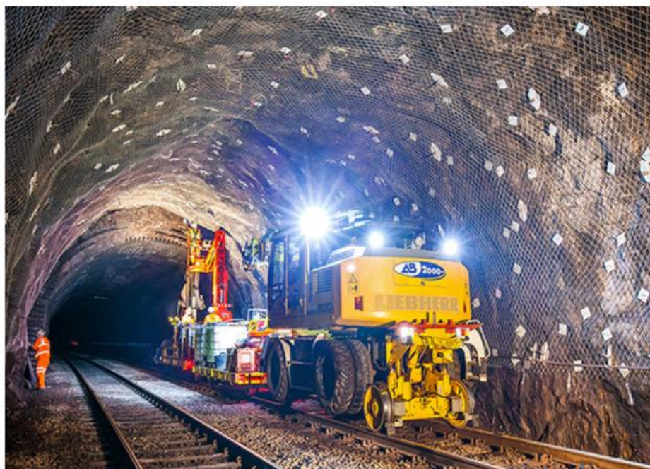
Slika 8.: Tunel s ugrađenim štapnim sidrima (Izvor: [20])
