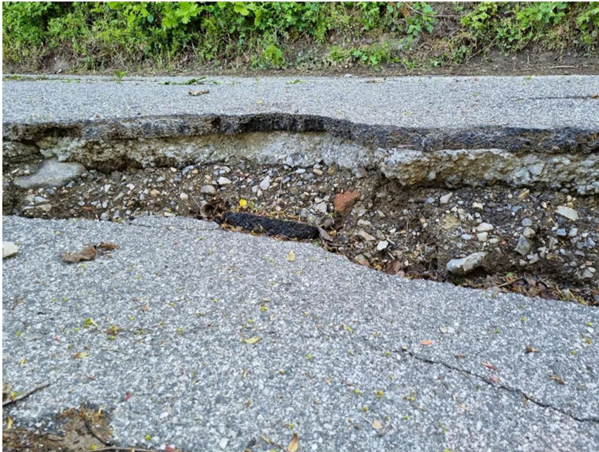
Slika 6 Pukotine u čeonoj zoni klizišta (Izvor: [1])
