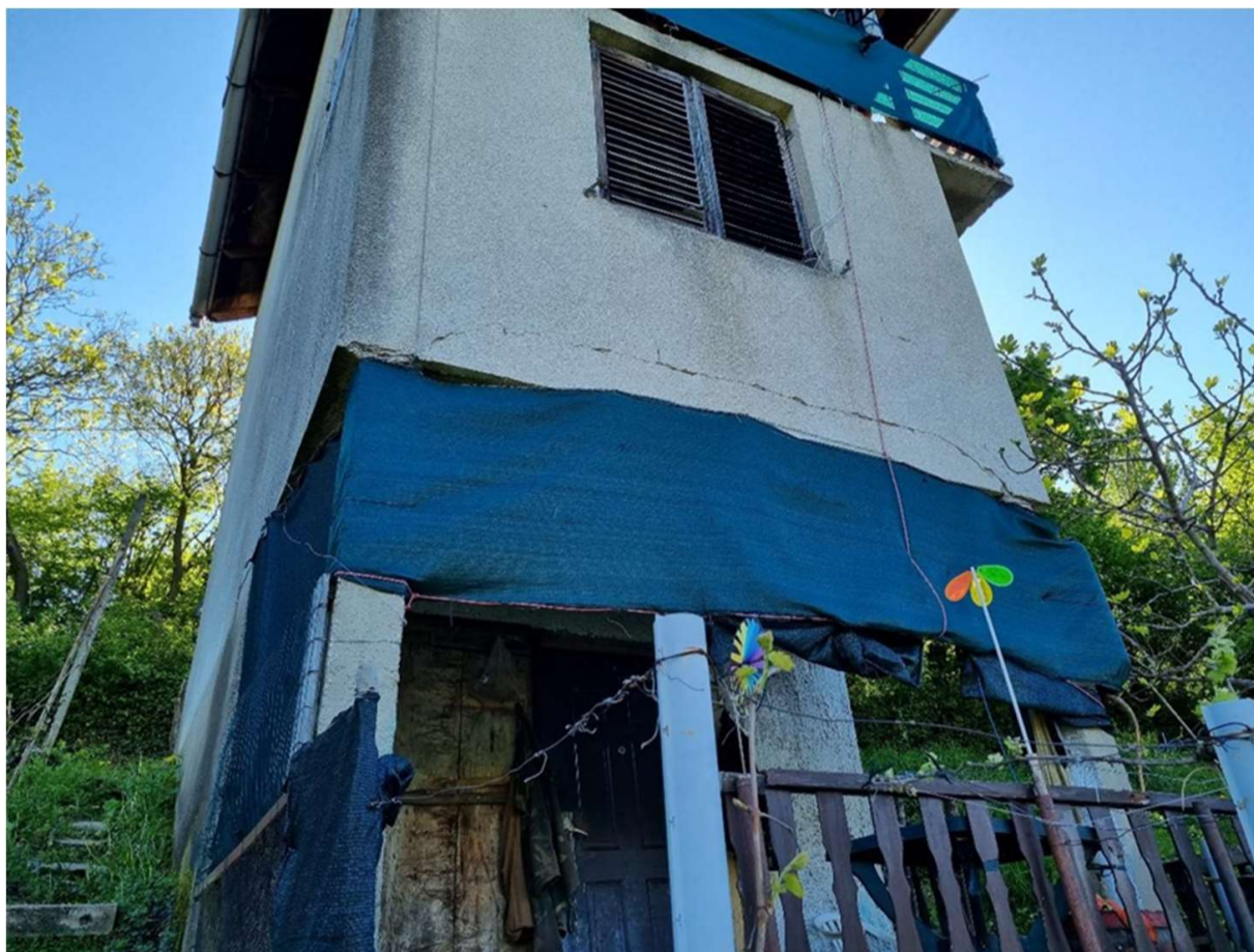
Slika 5 Vidljive pukotine na objektu ispod novonastalog klizišta (Izvor: [1])
