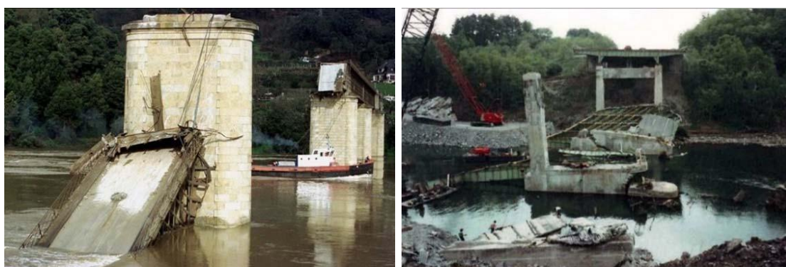
Slika 6,7. Posljedice rušenja mosta Hintze Ribeiro i Schoharie Creek
