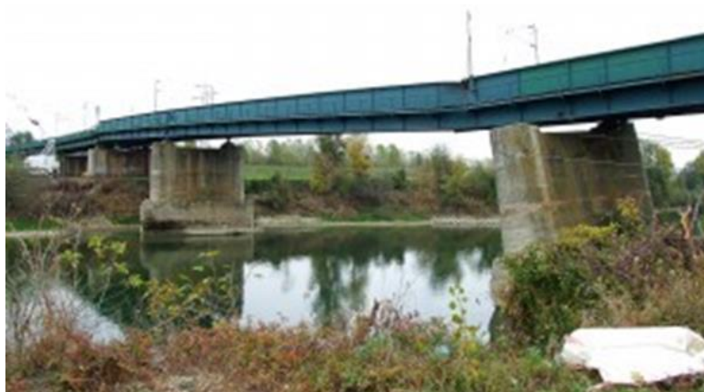
Slika 1 Most „Sava – Jakuševac“ nakon oštećenja
