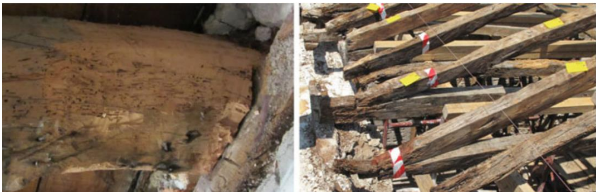
Slika 40. Primjer oštećenja oslonca veznih greda na nosivim zidovima [12]
