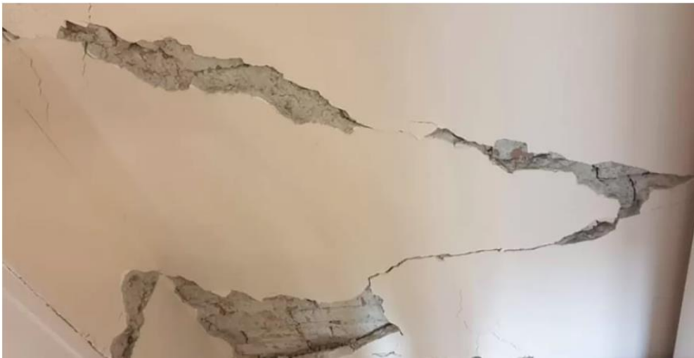
Slika 6: Dijagonalne pukotine u zidu kao posljedica potresa [7]
