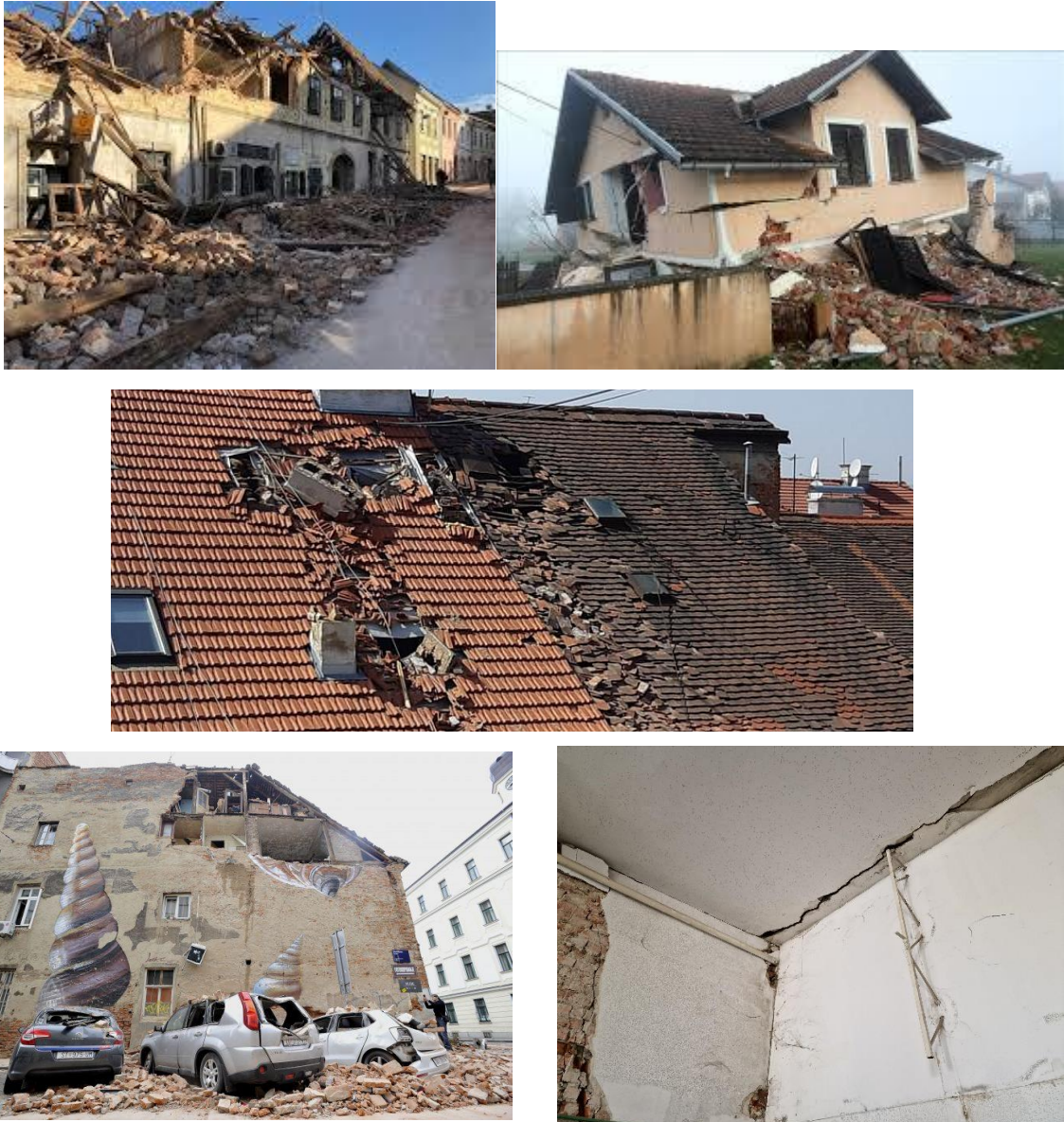
Slika 5: Primjer vanjskih i unutarnjih oštećenja građevina u Zagrebu (2)
