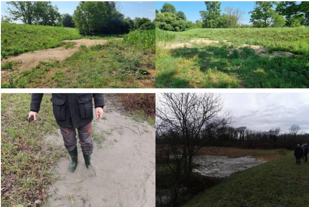
Slika 19.:Oštećenja nasipa (Izvor: [12])
