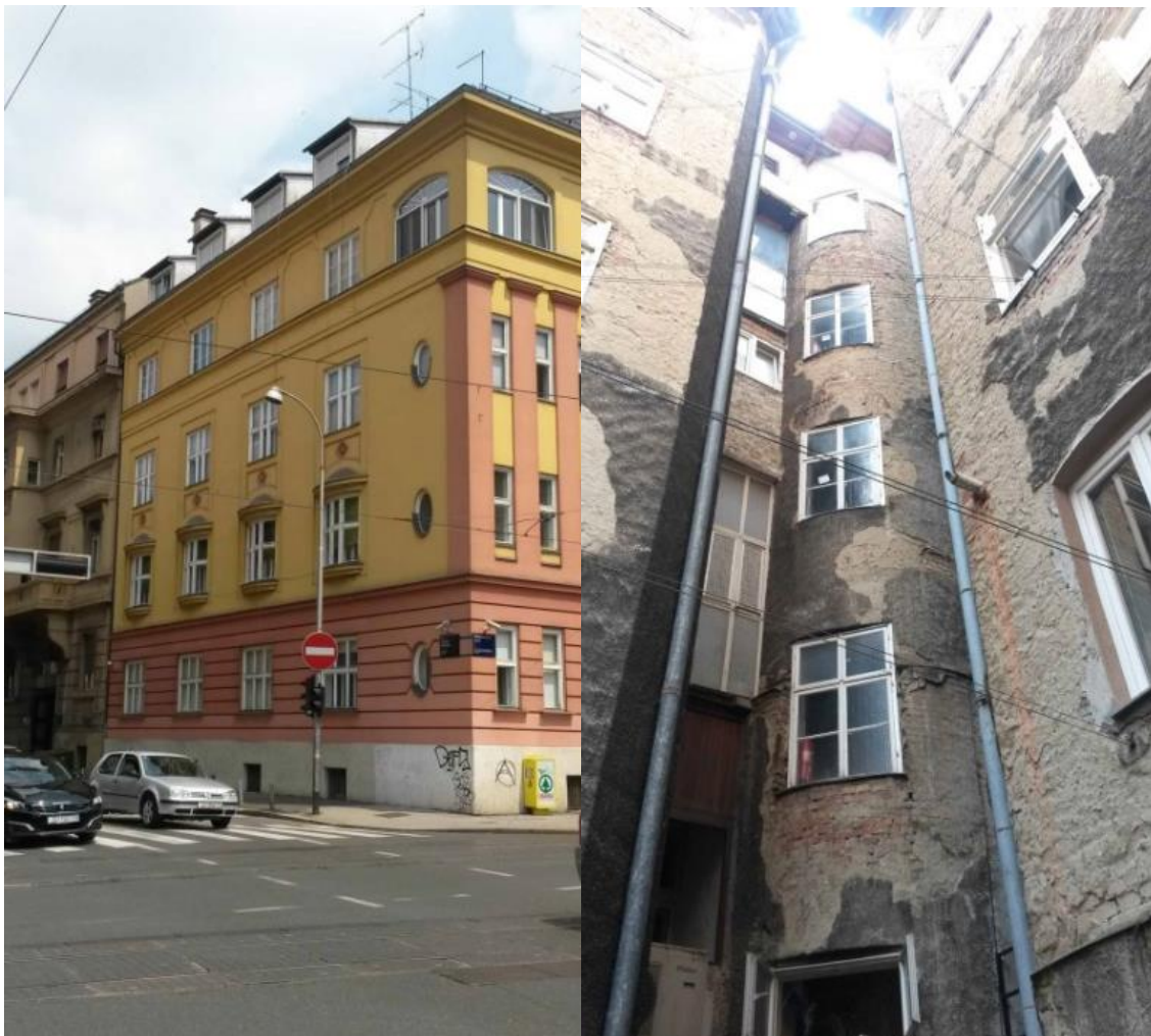
Slika 10.: Obnovljeno pročelje (lijevo) i zanemarena fasada dvorišnog dijela zgrade (desno) na adresi Mihanovićeve 20 [6]
