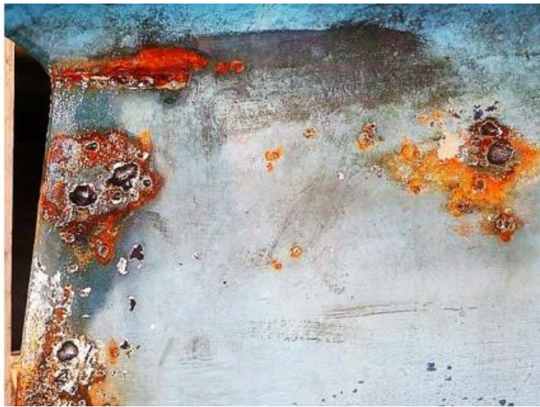
Slika 8.: Primjer pjegaste korozije [11]
