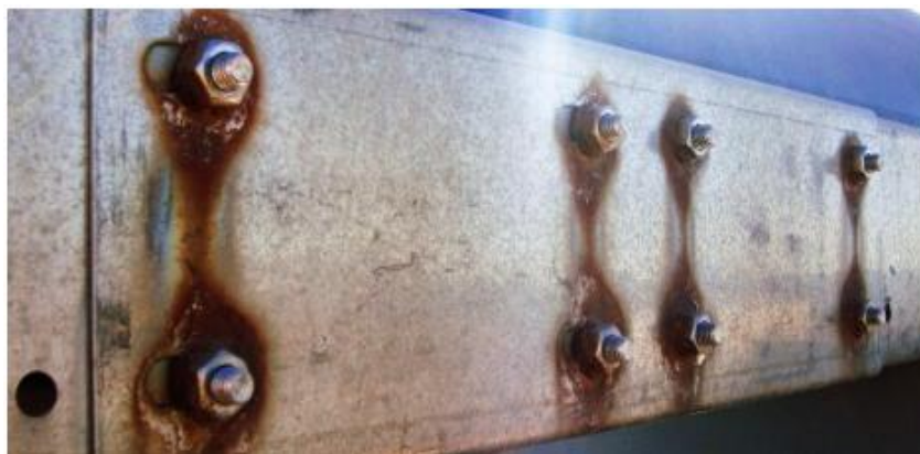
Slika 10.: Primjer galvanske korozije [13]
