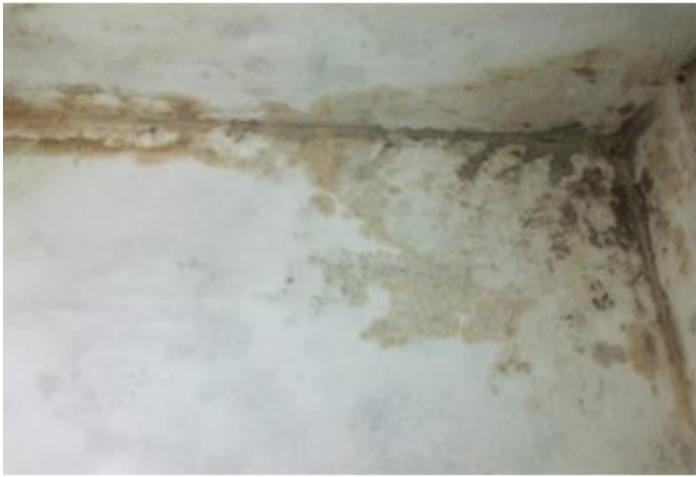
Slika 10: Pojava vlage i gljivica na zidu
