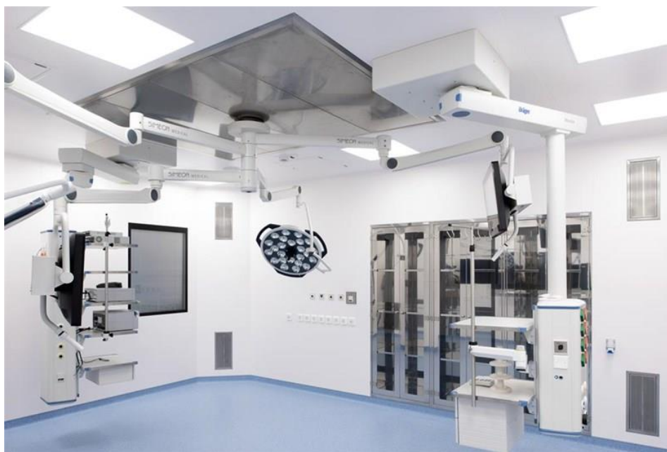
Slika 11. Operacijska sala koju je izvela Klimaoprema
