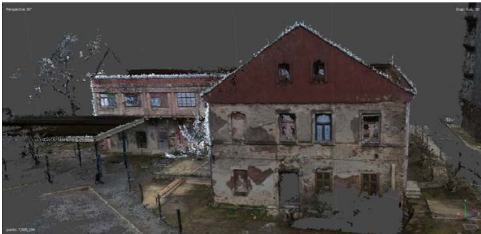
Slika 13 Dobra kvaliteta sjevernog pročelja
