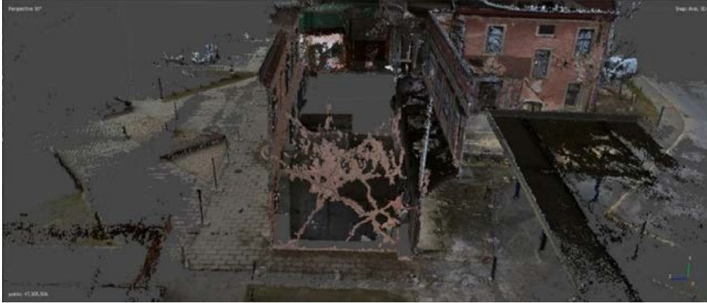
Slika 11 Loša kvaliteta istočnog pročelja
