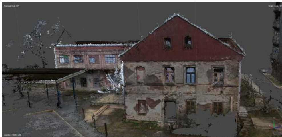
Slika 13 Dobra kvaliteta sjevernog pročelja
