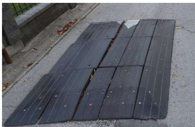
Slika 4 Primjer oštećene gumene uzdignute plohe [10]
