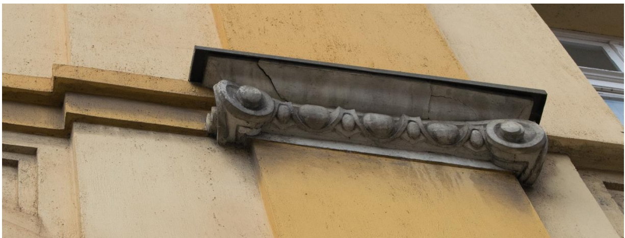
Slika 26 Oštećenje na štukaturama pročelja
