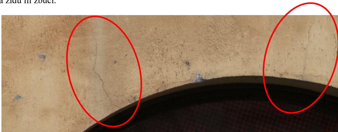
Slika 31 Pukotine na luku
