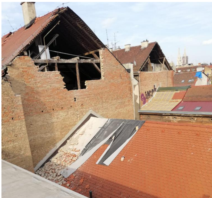
Slika 23 Zabatni zid susjedne građevine
