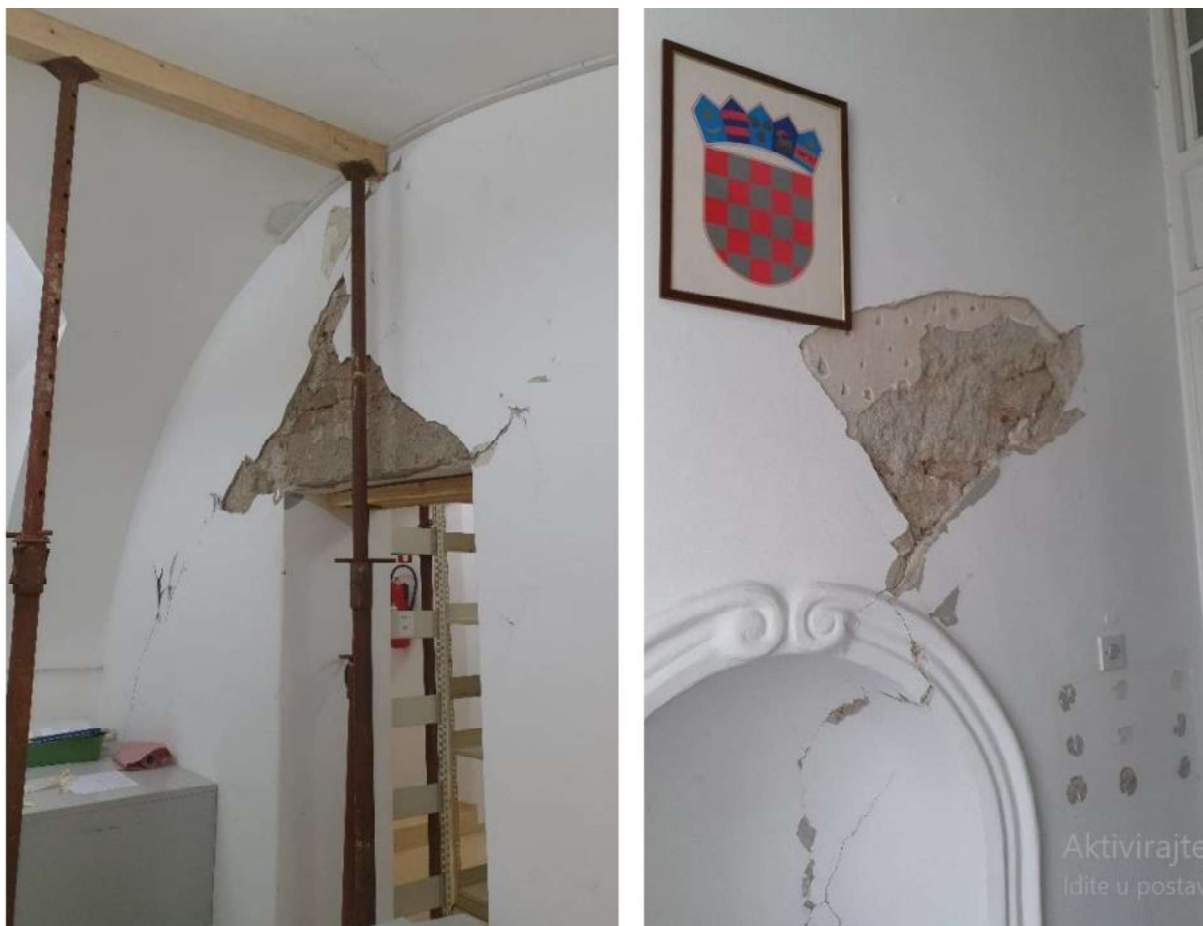
Slika 1 Pukotine, oštećenja i opadanje žbuke u prizemlju(Duvnjak,2021)
